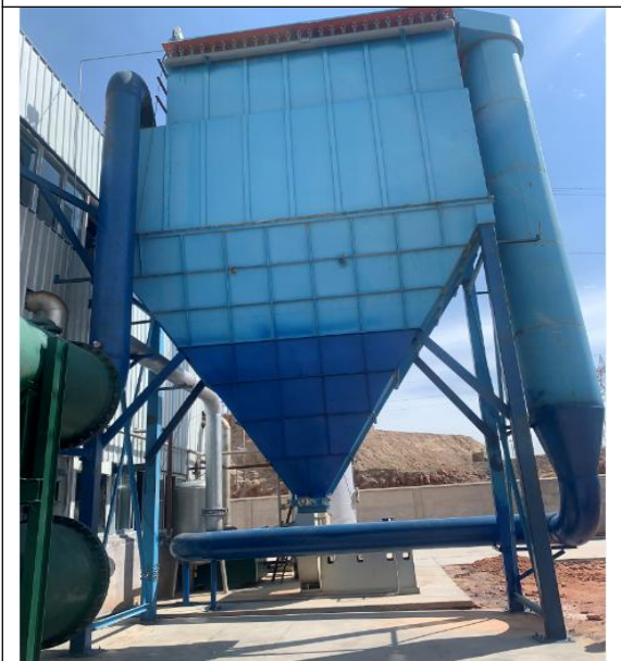
废气处理设施（除尘器）
