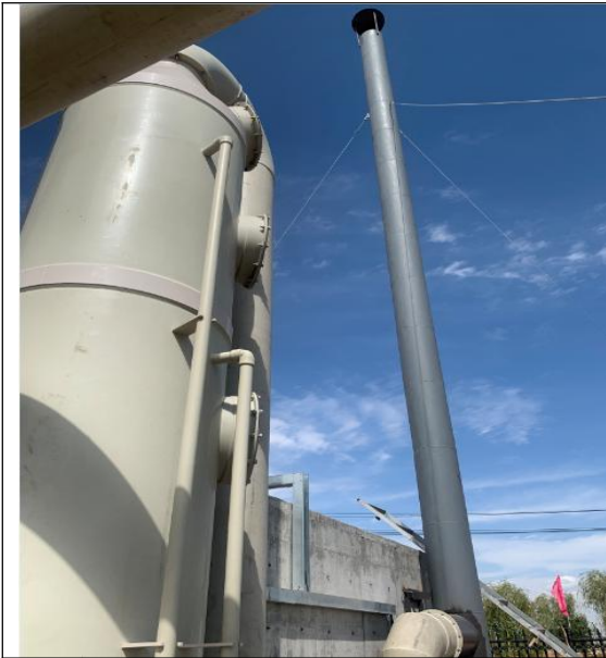
污水站废气处理设施及排放口
