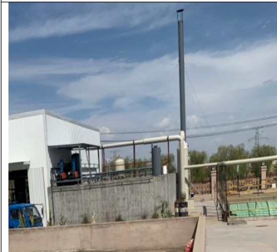
废水处理装置
