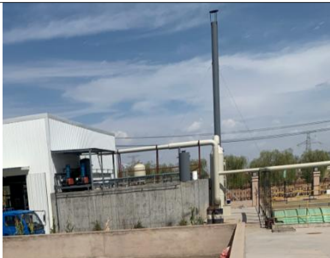
废水处理装置
