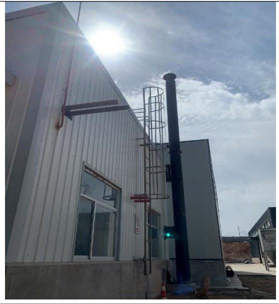
锅炉废气排气筒
