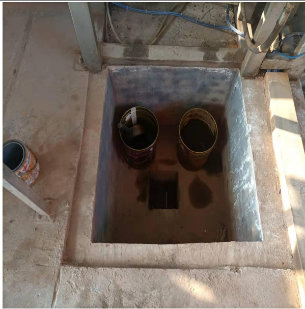
1座 1.5m 3 废油池
