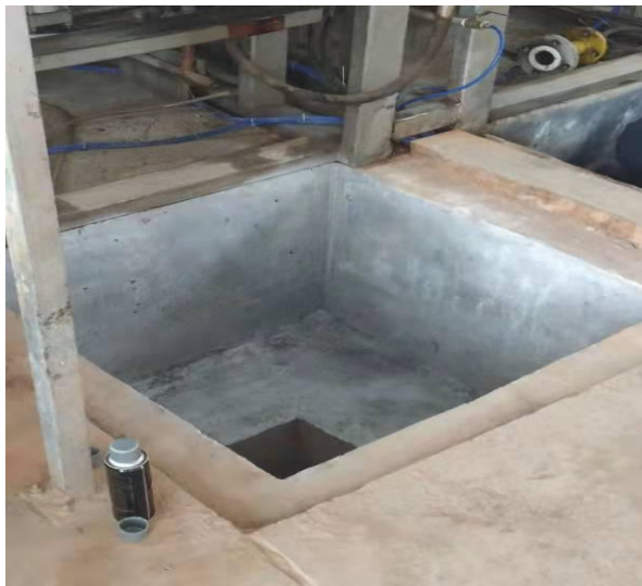
1座 0.5m 3 沉淀池
