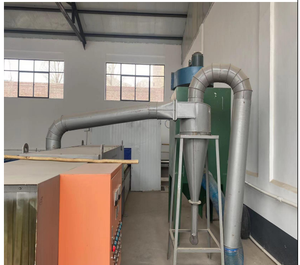
抛丸工序的废气治理设施
