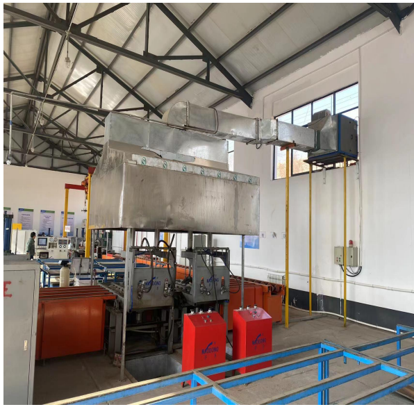
蒸汽吹扫工序的废气治理设施
